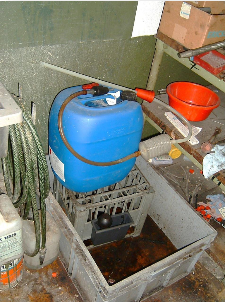
Säurestation in Autogarage
