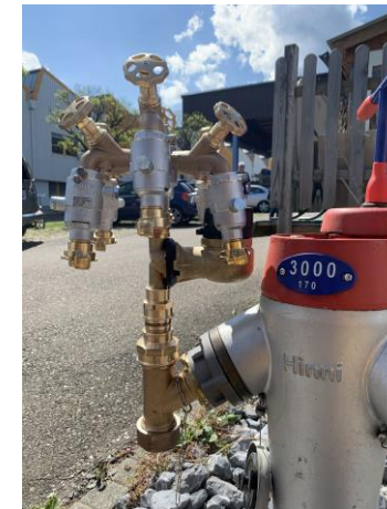
Provisorium mit Systemtrenngeräten Bauart BA
